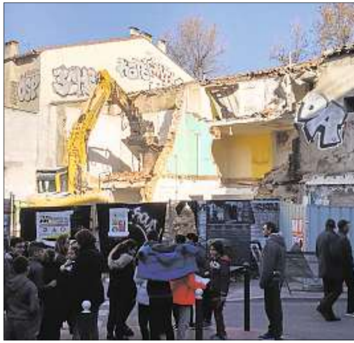
■ La pelleteuse est entrée en action côté rue de la Palissade. DR
